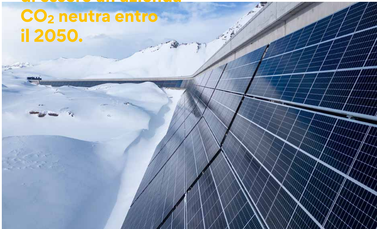
L'impianto solare da 2,2 megawatt presso la diga di Muttsee è stato costruito nel 2021 ed è il più grande della regione alpina. Produce 3,3 milioni di chilowattora di elettricità all'anno, che Denner acquisterà per 20 anni.
