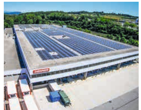
Auf den Dächern der Verteilzentrale Lyss wurde die erste Photovoltaik-Anlage von Denner installiert.
